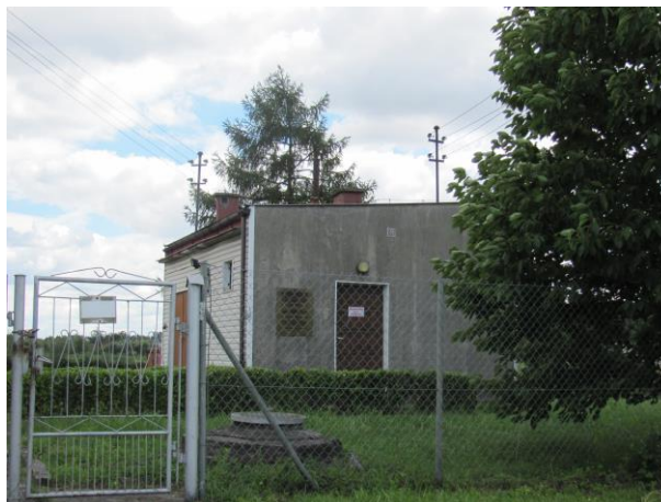
Fot. 41. Oczyszczalnia ścieków w Krasnem
